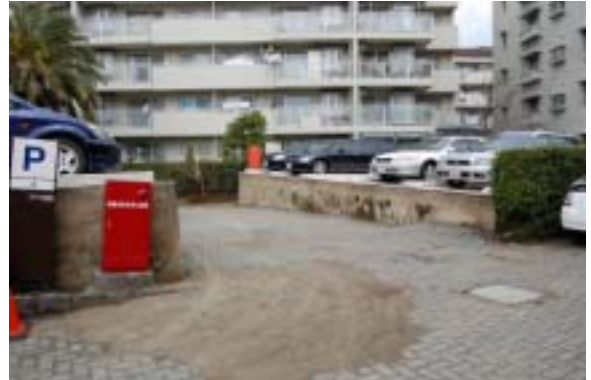
写真 液状化によるマンション駐車場の被害（千葉県内）
