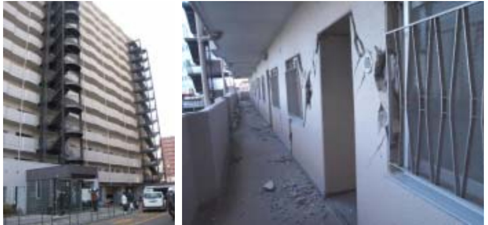
写真 仙台市若林区大和町5丁目の14階建てマンションの非構造壁の被害 (日本建築学会東北支部HPから)
