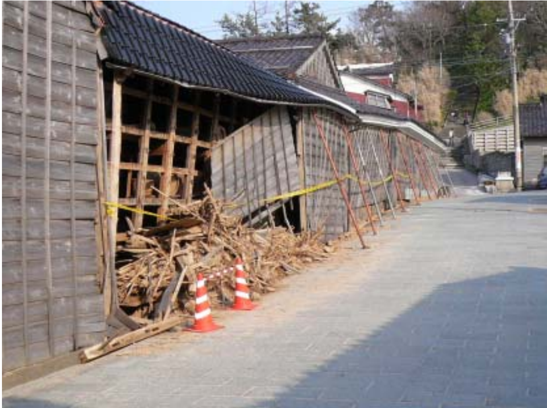
⑤震災直後の旧角海家周辺
